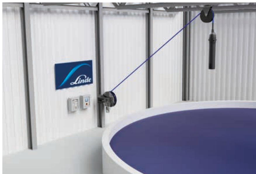
■ SOLVOX súrefnisinnlosunarbúnaður frá Linde sem notaður er þegar verið er að tæma eldistankana og við neyðaraðstæður.
