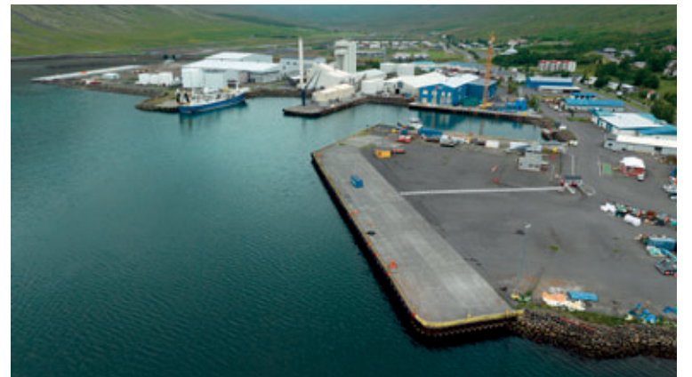
■ Þrjár af fimm aflagæstu höfnum landsins eru í Fjarðabyggð og Eskifjarðarhöfn er ein þeirra. Þar er verið að ljúka framkvæmdum við bryggju í tengslum við nýtt uppsjávarhús og frystigeymslu Eskju.
