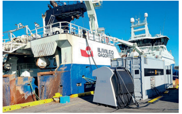
■ Grænlenstur togari tengdur við rafmagn á Hvaleyrarbakka. Tugir skipa hafa nú verið tengd við rafmagn í Hafnarfirði og er nýbyrjað að tengja við Miðbakka í Reykjavík.
