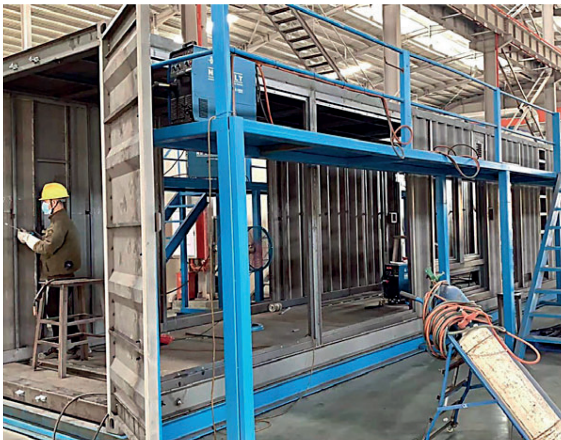
■ Uppsetning á gámi fyrir varaafstöð. Vélin er af gerðinni Mitsubishi S16R-PTA2 1750 kVA PRP.
