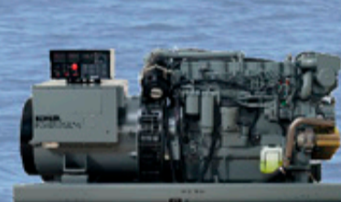
Rafstöðvar og ljósavélar
