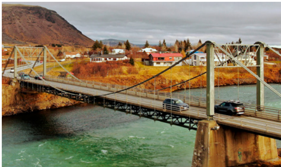
■ Núverandi brú yfir Ölfusá hefur þjónað vel og lengi en nú er áformað að létta álaginu á þennan aldna höfðingja. Brúin verður áfram nýtt innsveitar á Selfossi.
